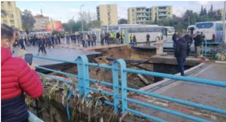
Figure 4 : Oued El Kantara à Jijel, où des dégâts occasionnés par des pluies torrentielles suite à l'obstruction de la galerie bétonnée canalisant le cours d'eau. (Source : elmoudjahid.com, 2020)
