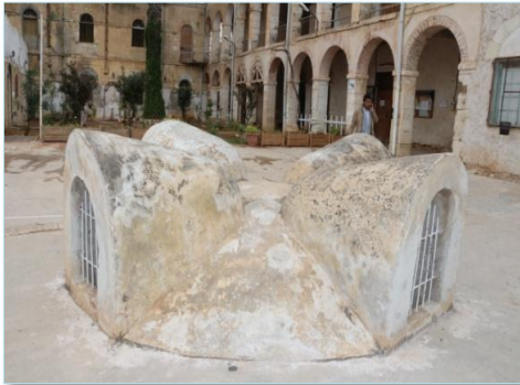
الصورة 2 : بقع سوداء ناجمة عن الطحالب الزرقاء
